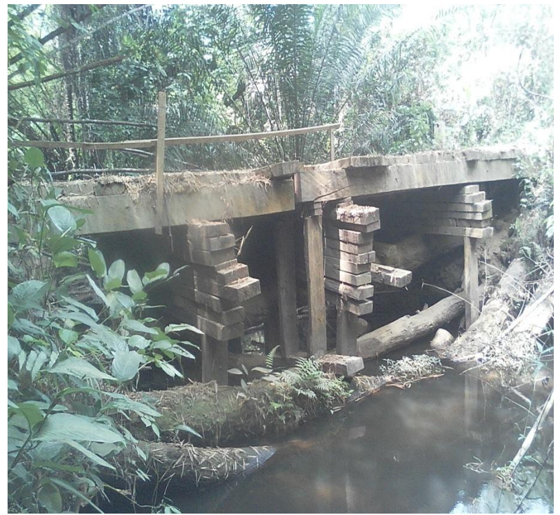
Photo 11 : Pont en piteux état
