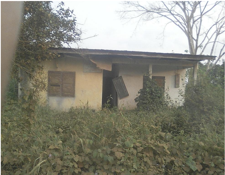
Photo 6: Poste agricole de MIANG abandonné
