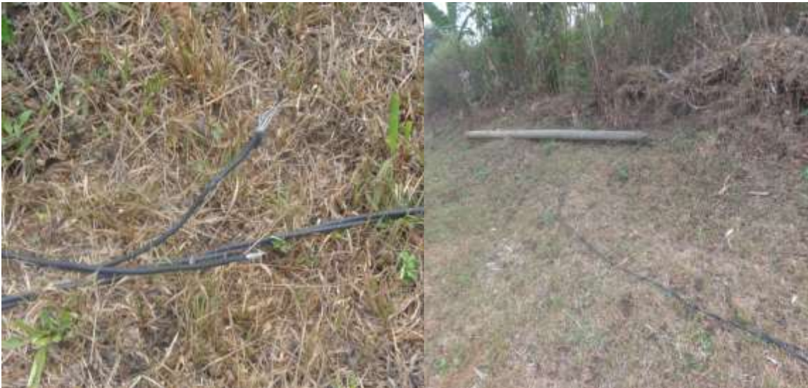
Photo 15: Un câble de fil électrique et un poteau endommagés dans la ville de Dzeng Ville
