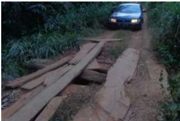
Photo 16 : Pont dégradé à Ngat I
