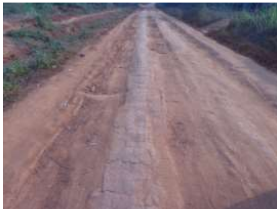
Photo 17 : Route dégradée à Nkoeyen
