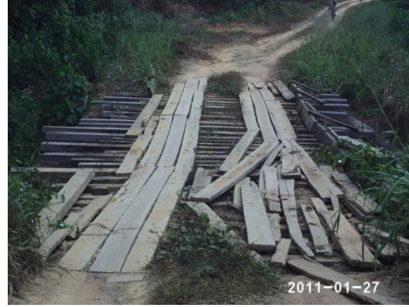
Photo 6 : pont en état de délabrement sur LONGO entre Nsonga et Song
